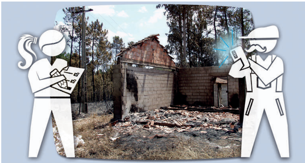
Fig. 77 Avalie os danos no edificado.
